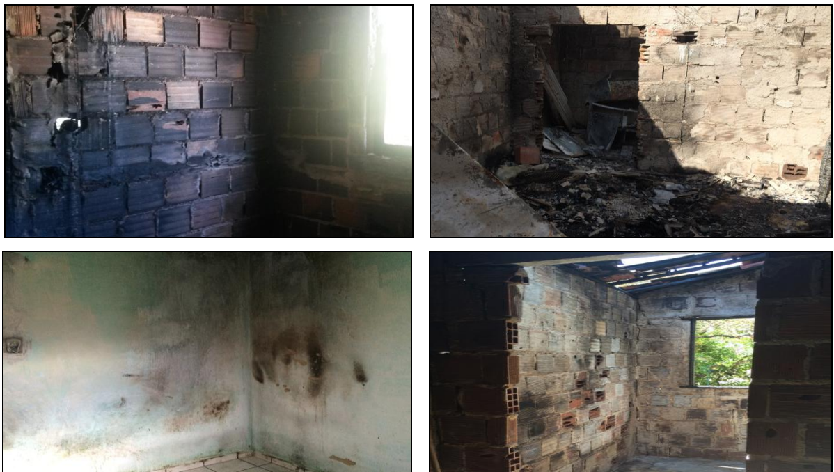
Figura 20 - Danos ocasionados na alvenaria estrutural de algumas residências em virtude do incêndio.
