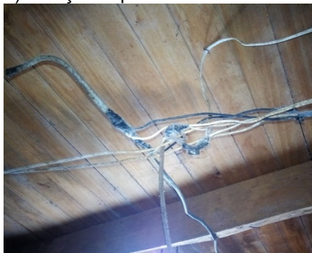
a) Fiação exposta
