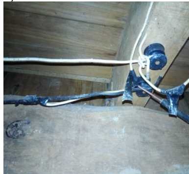
b) Isolamento entre os fios ruim
