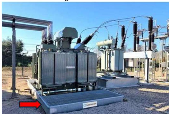
Figura 4 - Bacia de captação de óleo em transformadores, fabricada em chapa galvanizada.
