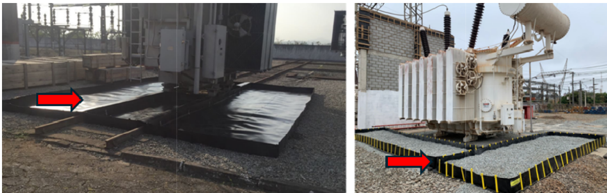
Figura 5 - Bacia de contenção de óleo em transformadores, fabricada em PEAD.
