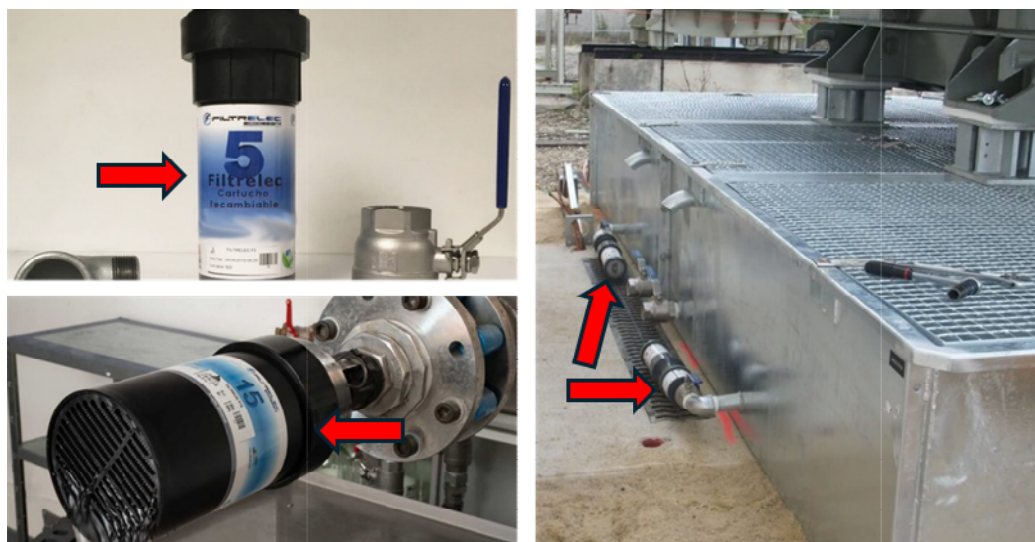
Figura 6 - Filtro de águas contaminadas por hidrocarbonetos instalado em bacias especiais de captação de óleo.
