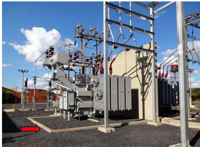
Figura 3 - Bacia de captação de óleo construída sob o transformador.
