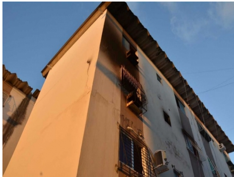
Fotografia 2 – Prédio tipo caixão interditado após incêndio
