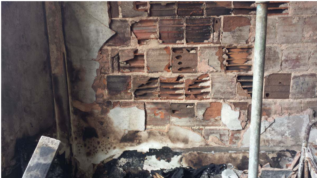
Fotografia 4 – Parede longitudinal externa do quarto, trecho próximo da parede transversal externa, com danos no reboco, argamassa de assentamento e blocos
