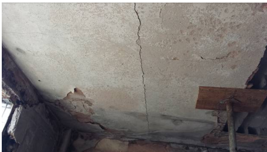
Fotografia 7 – Laje do teto no apartamento 902: trinca paralela às nervuras
