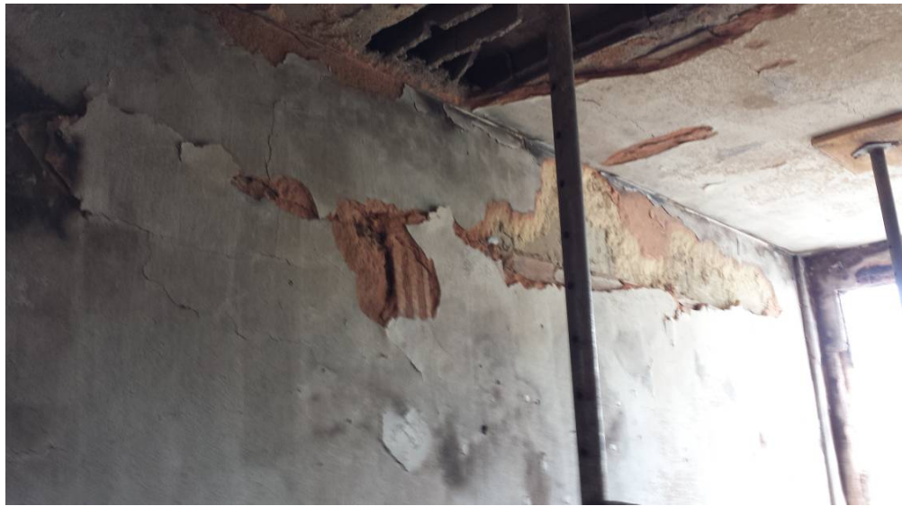
Fotografia 6 – Parede longitudinal interna: dano nas argamassas de assentamento e de revestimento
