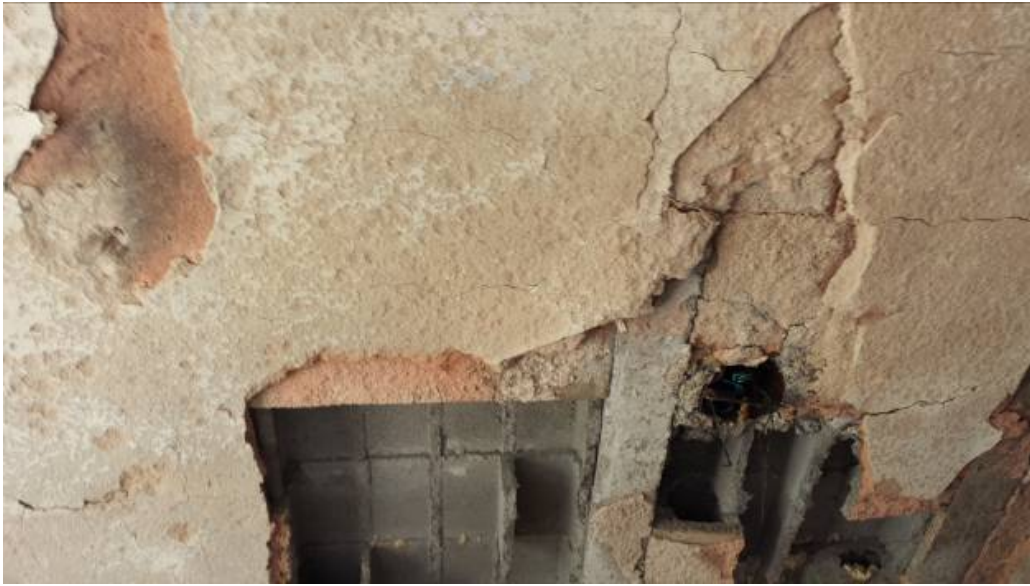
Fotografia 8 – Danos na argamassa de revestimento e blocos
