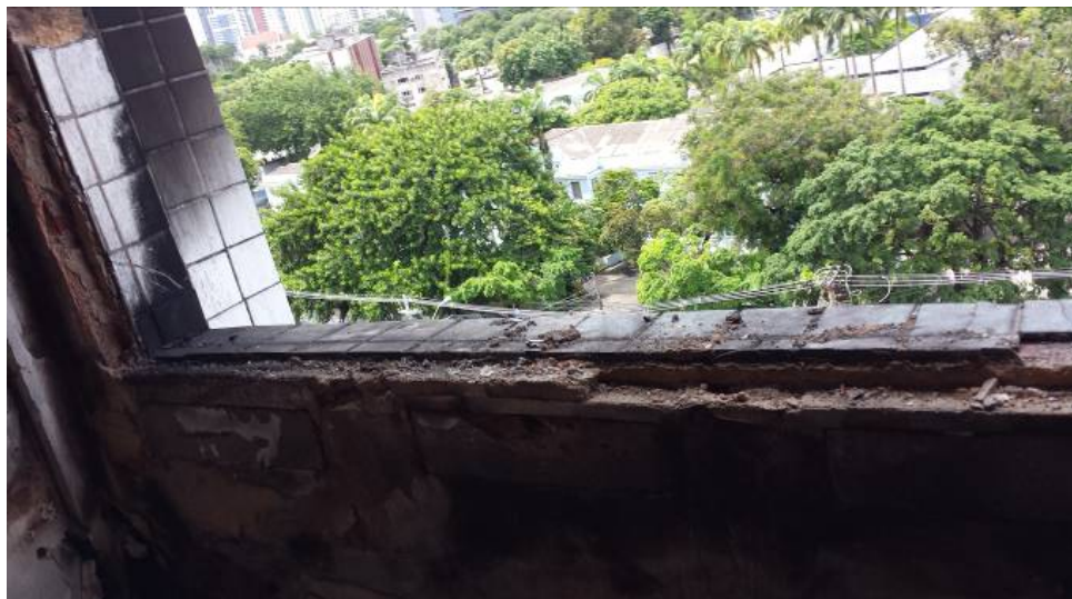
Fotografia 20 – Capiáculos da janela e peitoril danificados pelo incêndio
