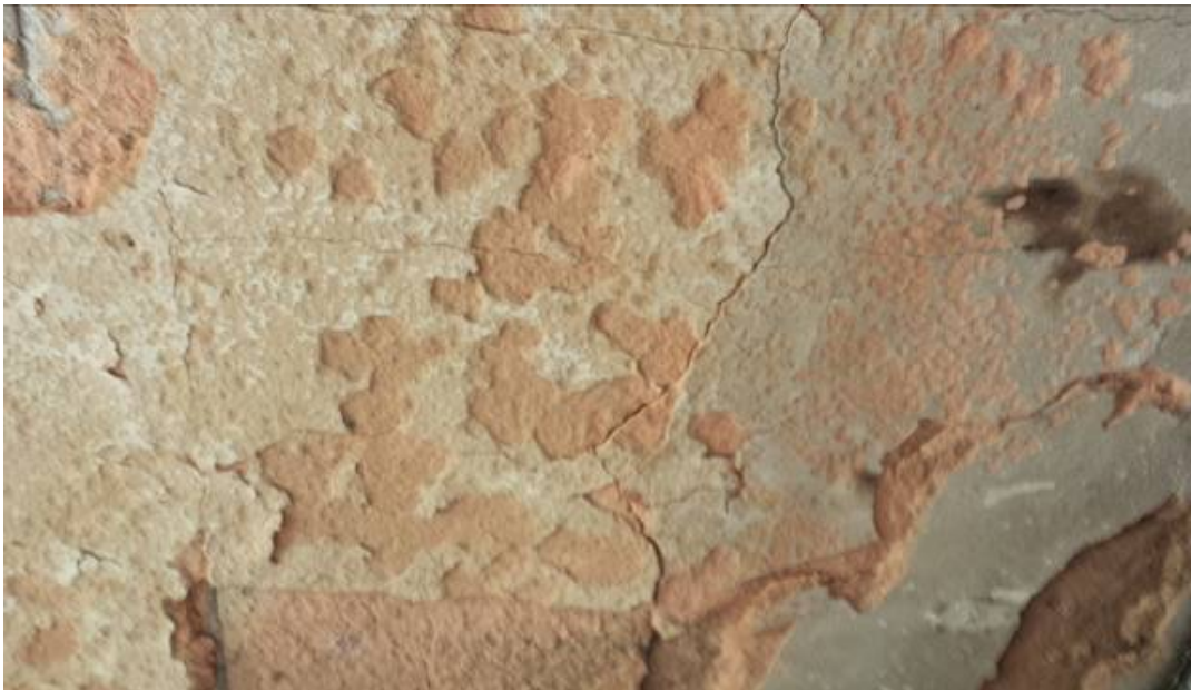
Fotografia 9 – Laje do teto no apartamento 902: trinca paralela às nervuras, dano na argamassa de revestimento composta de cimento, saibro e areia e nos blocos de concreto
