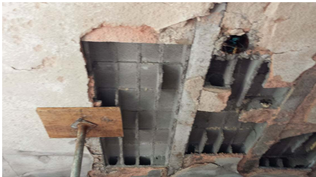
Fotografia 13 – Laje do teto no apartamento 902: danos na argamassa de revestimento e nos blocos de concreto
