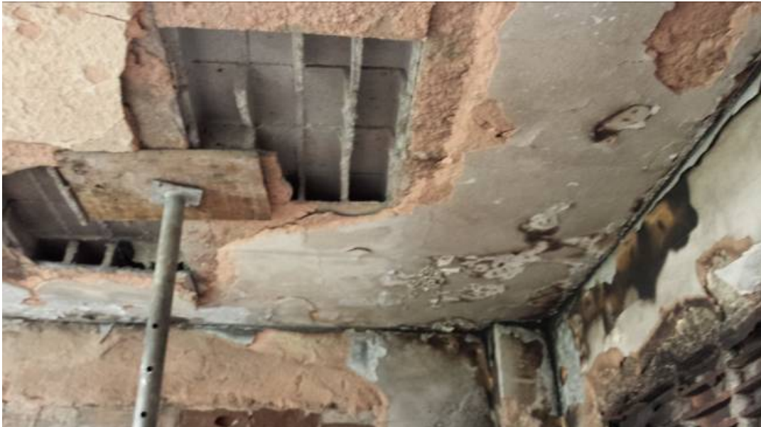
Fotografia 11 – Laje do teto no apartamento 902: danos na argamassa de revestimento composta de cimento, saibro e areia e nos blocos de concreto
