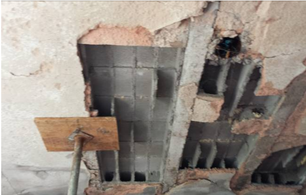
Fotografia 10 – Laje do teto no apartamento 902: trinca paralela às nervuras, dano na argamassa de revestimento composta de cimento, saibro e areia e nos blocos de concreto
