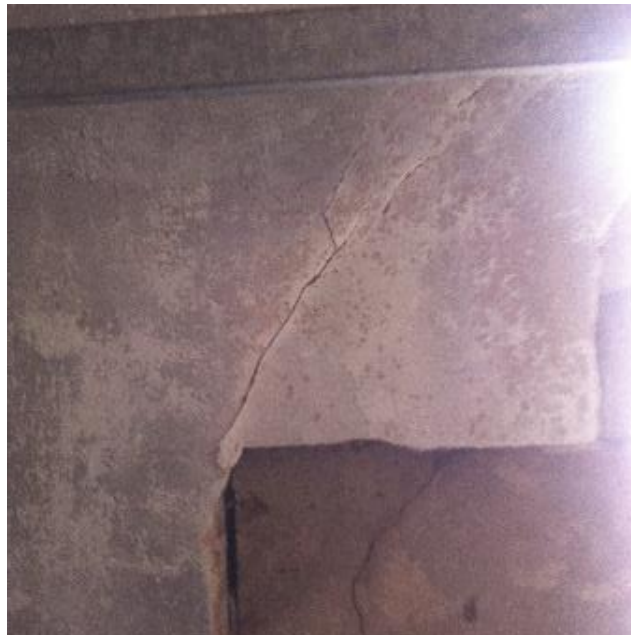
Fotografia 7 – Revestimento destruído e fissuras no bloco de concreto em consequência do incêndio
