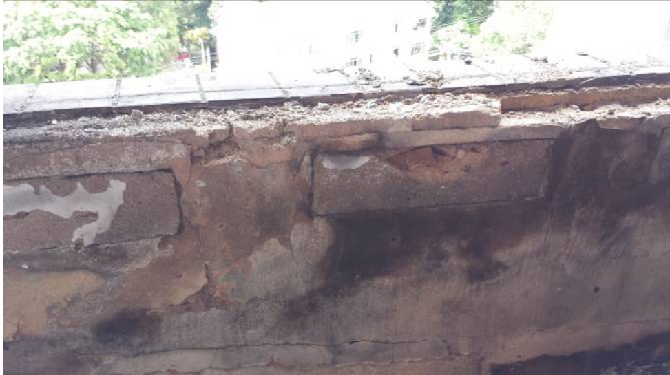
Fotografia 21 – Capiços da janela e peitoril danificados pelo incêndio
