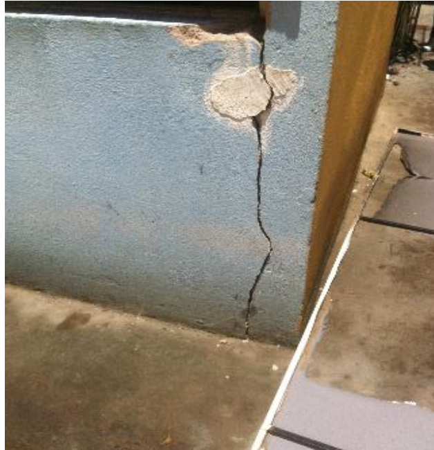
Fotografia 1 – Parede externa com severa fissura ocasionada pela explosão por ocasião do incêndio
