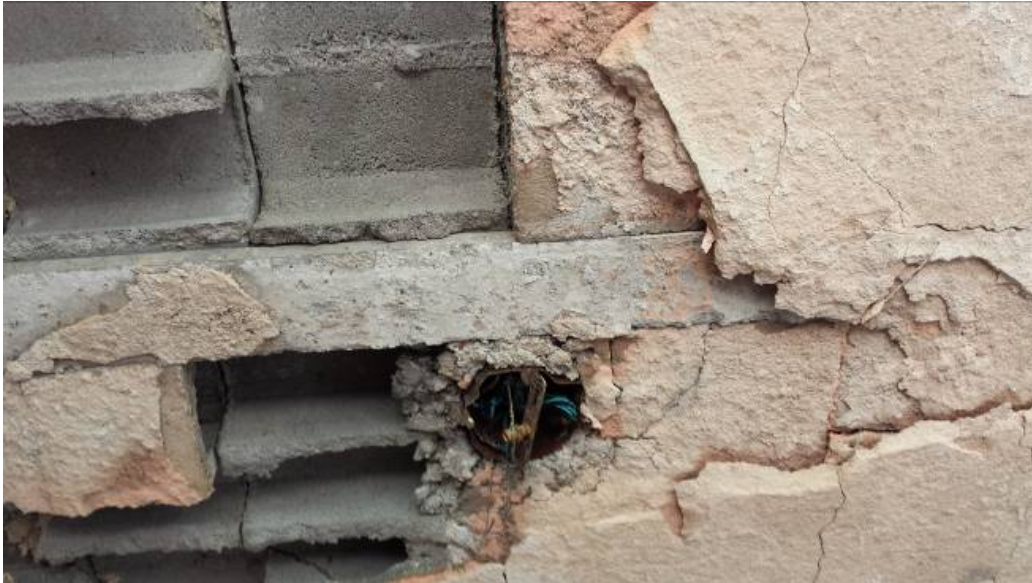
Fotografia 12 – Laje do teto no apartamento 902: danos na argamassa de revestimento composta de cimento, saibro e areia e nos blocos de concreto
