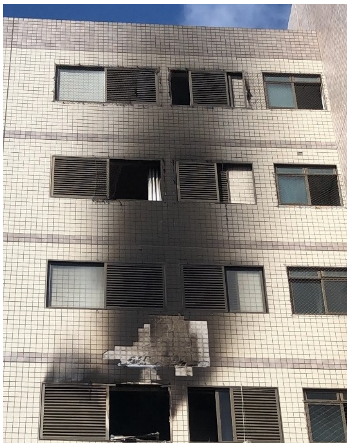
Figura 5 – Fachada do prédio após o sinistro
